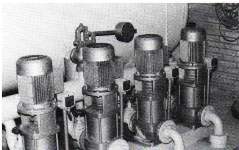
Betjeningen af vandværket foregår i dag via moderne installationer
